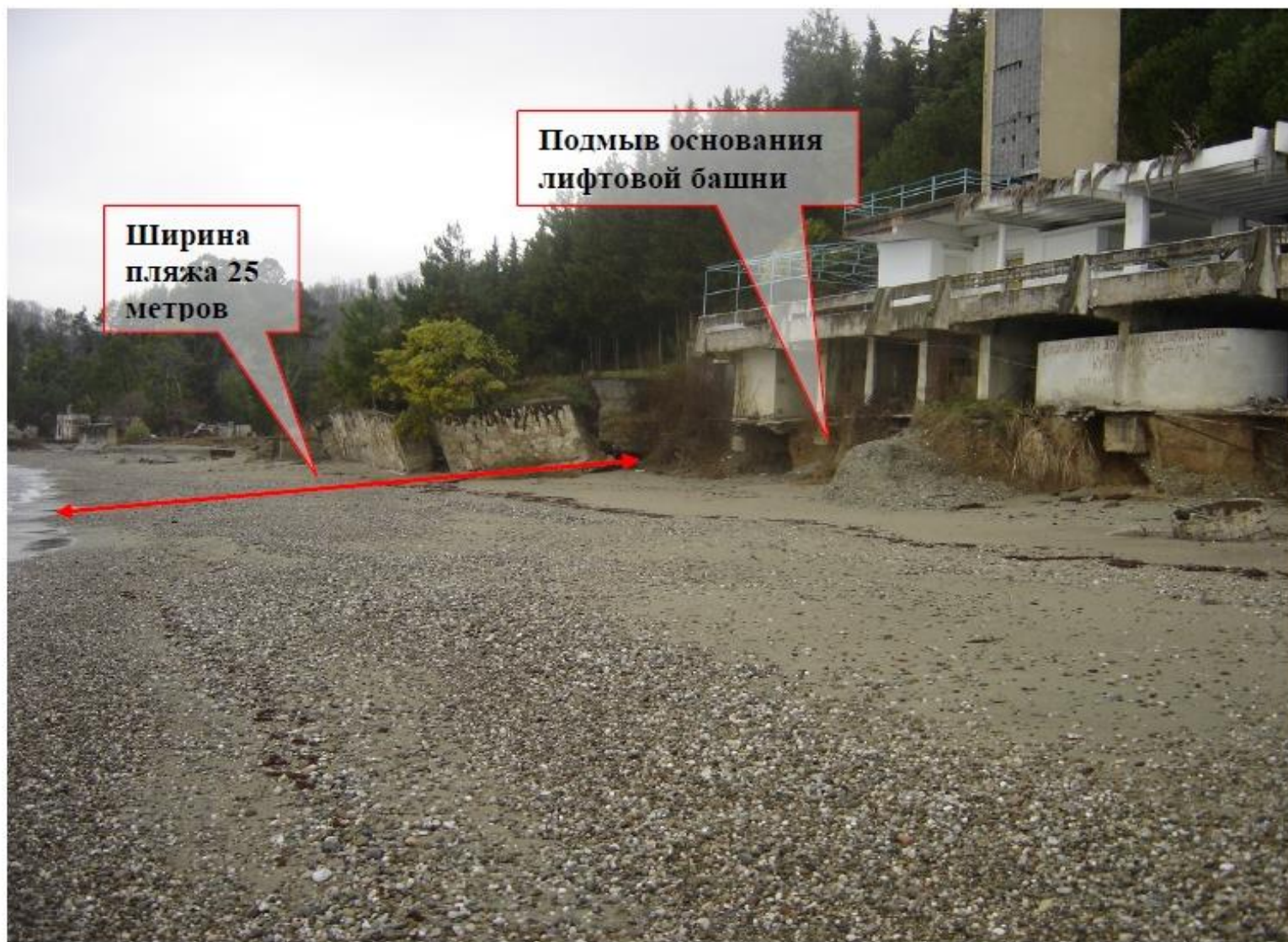
Рис 14. Сокращение ширины пляжа и подмыв лифтовой башни санаторного комплекса
