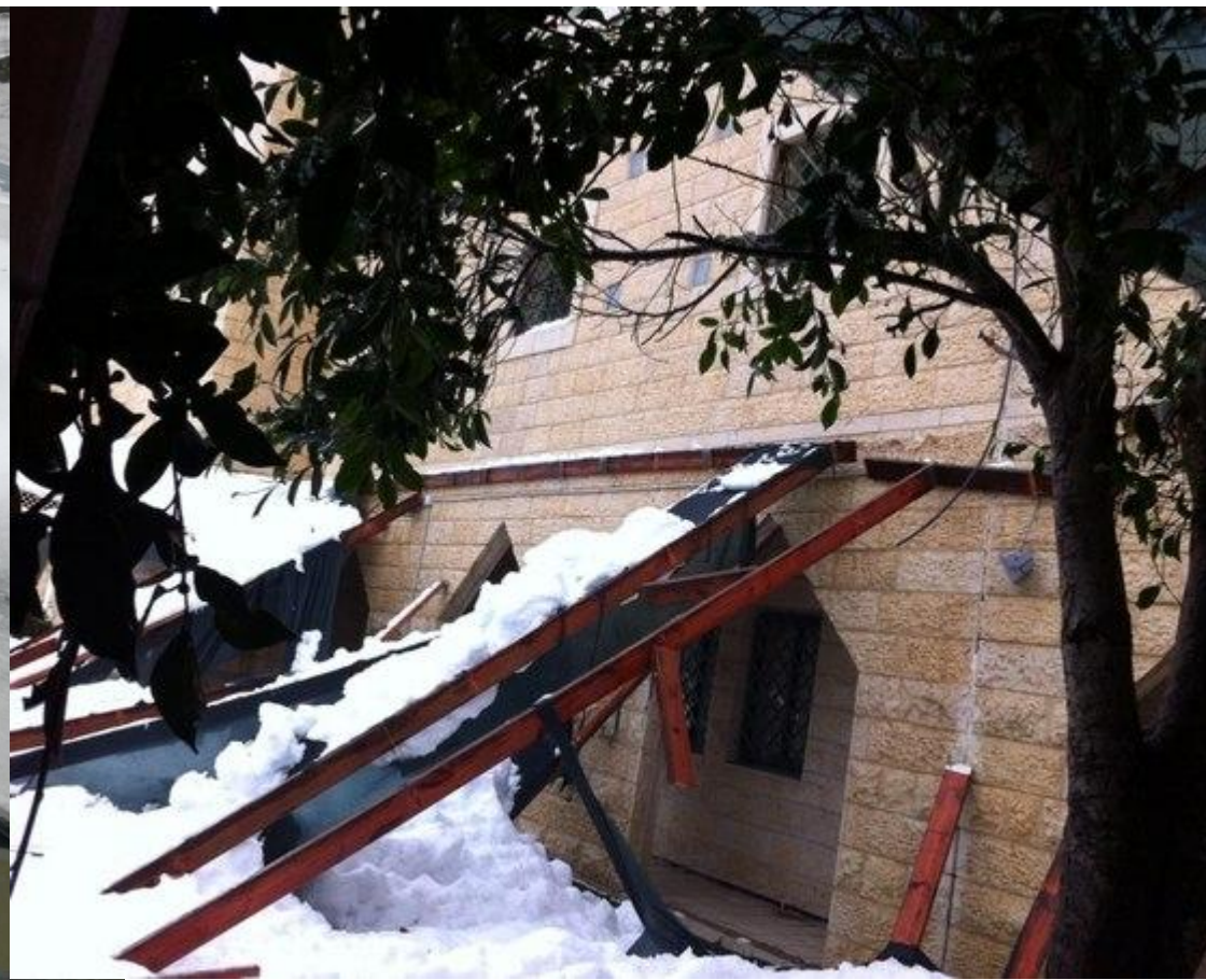
Обрушение крыши в городе Бейтар Илит 14 декабря 2013
