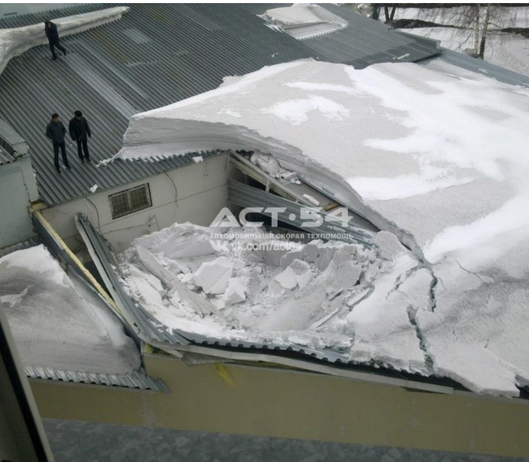
Снег обрушил крышу офисного здания в Новосибирске 5 апреля 2013
