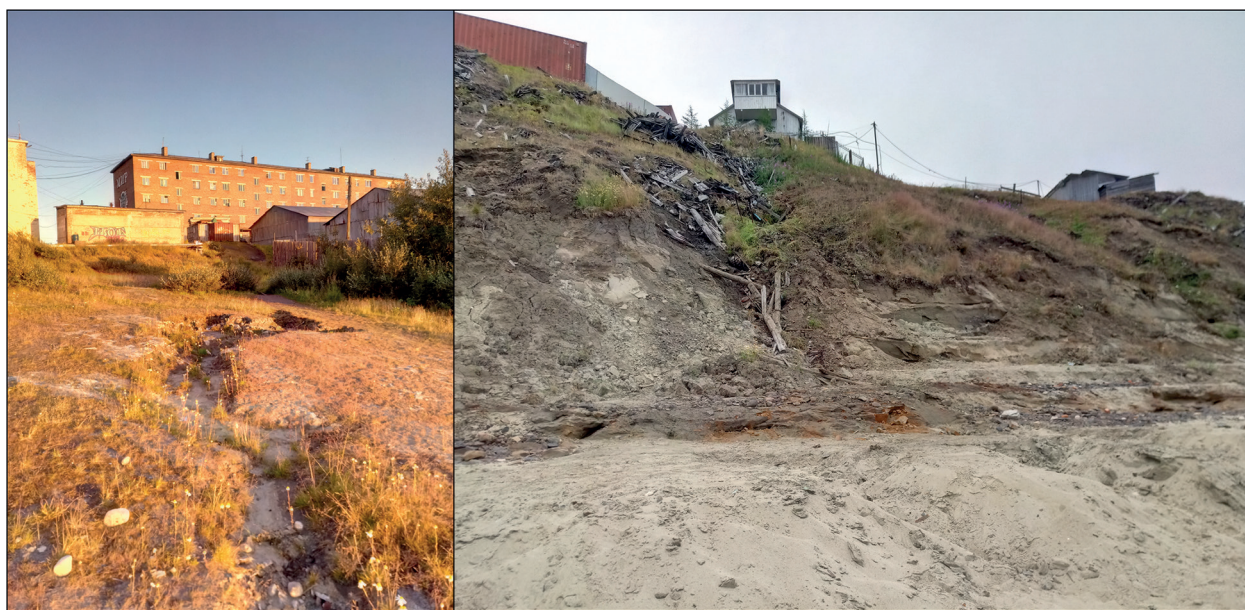
Рис. 7. Эрозионные процессы на высоком правом берегу р. Хатанги
